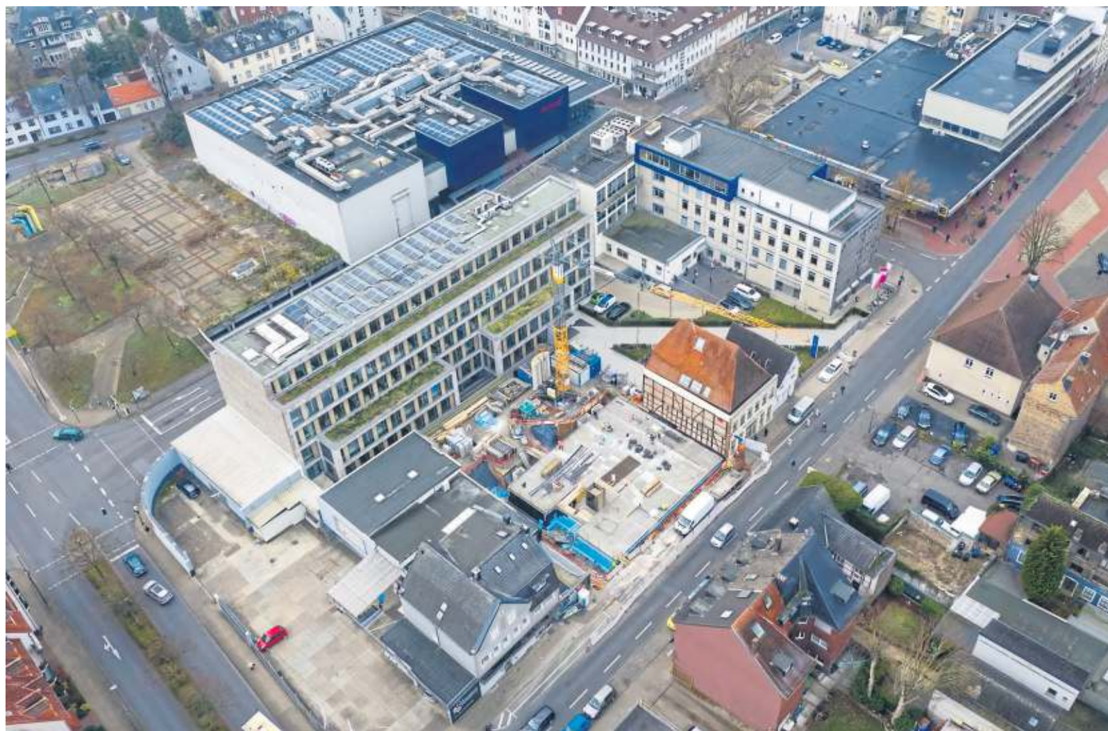
Teamwork: Bei einer Baustelle wie die beim neuen WA-Verwaltungsgebäude in der Widumstraße müssen viele Beteiligte zusammenarbeiten. FOTO: KASTIEN ARCHITEKTEN
